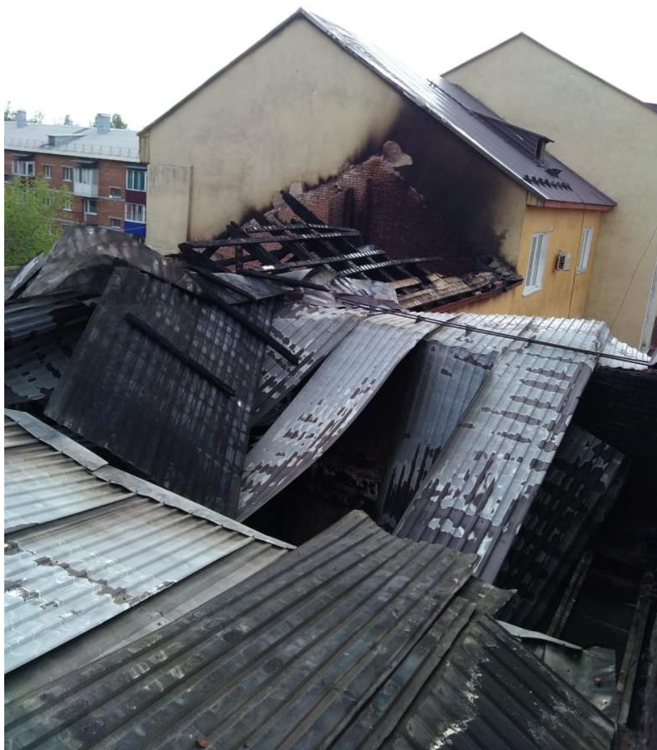
Рисунок 1 . Исследование крыши после пожара в г. Прокопьевске
