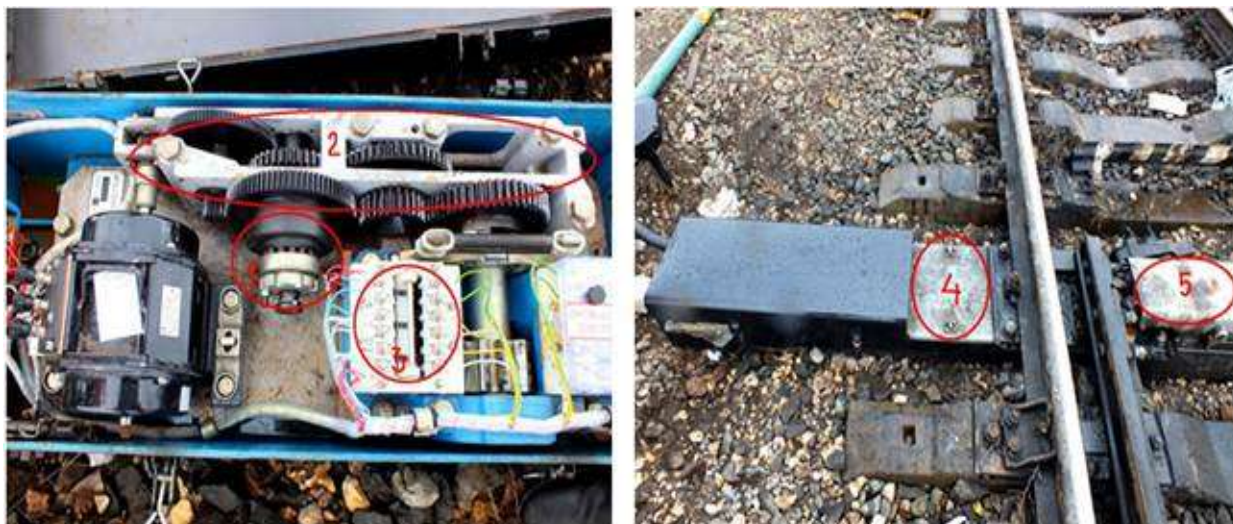
Рисунок 3. Оборудование электропривода УПС.
